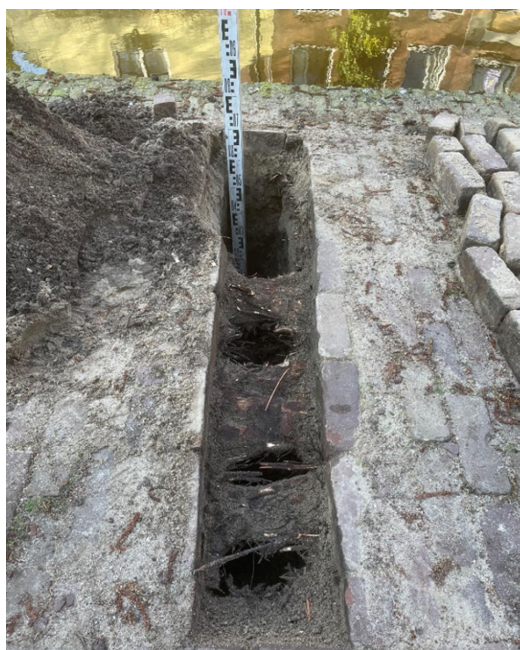
Figuur 3.23 Profielsleuf ter hoogte van Molstraat 111-122: opvallend dichte, dunne laag relatief fijne wortels direct onder de klinkers
