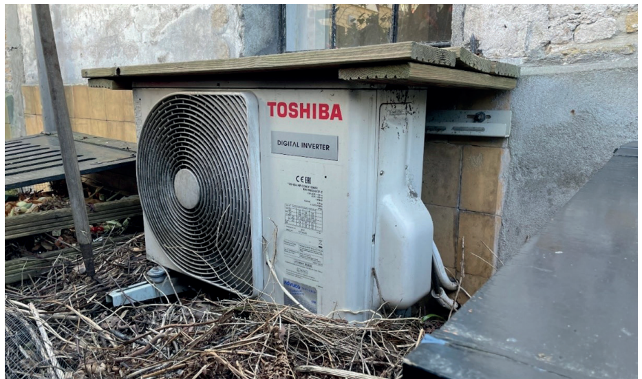
Foto: Royal HaskoningDHV (2023), Lucht-waterwarmtepompen in de historische binnenstad van Delft, p. 33
