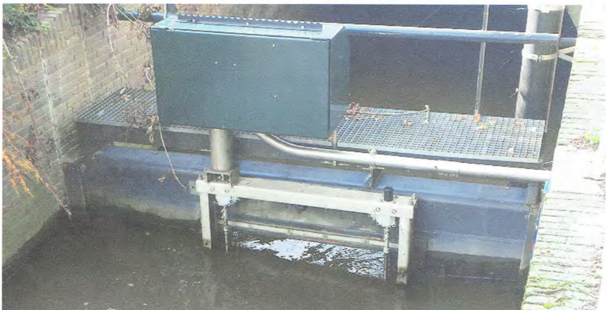
Figuur 11: Nu luchtvoerende aangepaste afsluiter aan de Vlamingstraat
